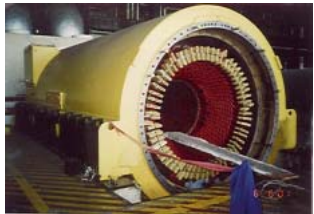
Slika 5 : Glave kanura sinhronog generatora 250 MVA
