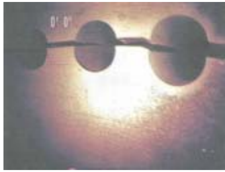
Sl. 8: Prsline na bubnju kotla (heder pare Ø400x14000 mm), registrovane video kamerom na robotizovanom vozilu (digitalna slika)
