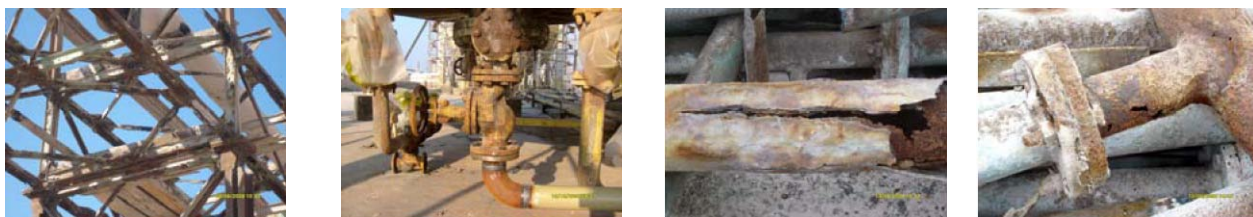
Slika 1. Primeri korozionog oštećenja konstrukcija cevovoda
