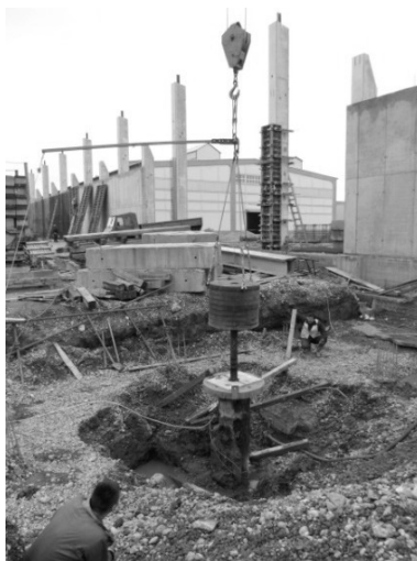
Slika 12. Dispozicija dinamičkog ispitivanja šipa \varnothing 600 mm, dužine L=11,6 m u okviru fabrike Zorka Šabac
