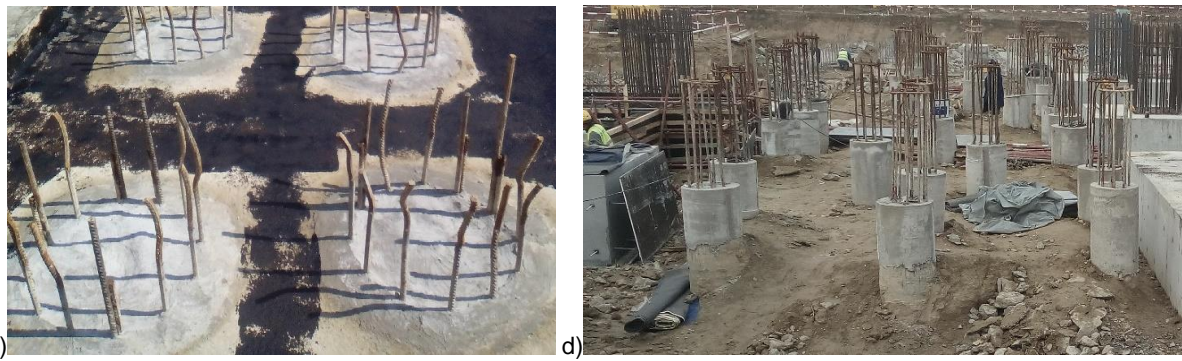
Slika 2. Šipovi (glave šipova) pripremljeni za ispitivanje testom integriteta šipa sa senzorom (SIT): a) adekvatna priprema; b) neadekvatna priprema; c) adekvatna priprema, međutim rezultati SIT na ovako pripremljenim glavama šipa sa hidroizolacijom mogu biti diskutabilni; d) nastavci glava šipova koji mogu biti problematični u smislu interpretacije signala SIT
