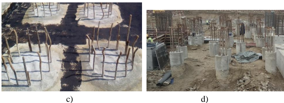
Slika 3. Šipovi (glave šipova) pripremljeni za ispitivanje testom integriteta šipa sa senzorom (SIT): a) adekvatna priprema, b) neadekvatna priprema, c) adekvatna priprema, međutim rezultati SIT na ovako pripremljenim glavama šipa sa hidroizolacijom mogu biti diskutabilni, d) nastavci glava šipova koji mogu biti problematični u smislu interpretacije signala SIT [7]
