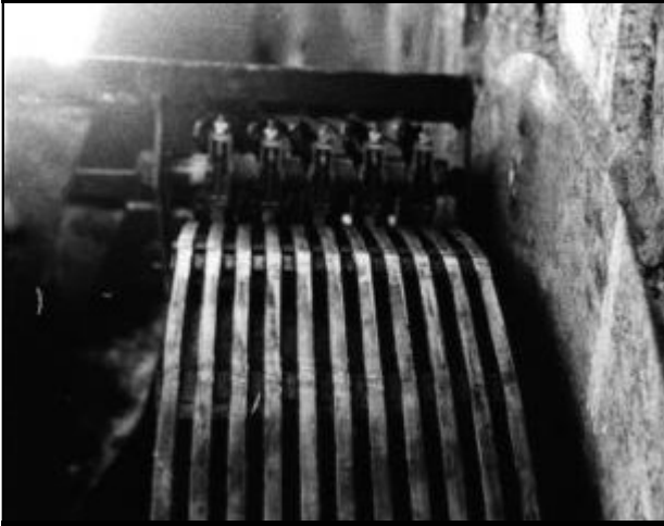
Slika 19. Mesto postavljanja bakarnih prstenova i kontaktnih četkica
