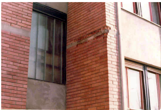
Sl. 3: Prikaz oštećenja fasadne obloge od opeka usled vlažnog širenja
