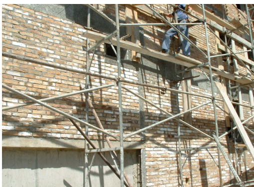
Sl. 12: Pojava iscvetavanja rastvornih soli u toku gradnje objekta
