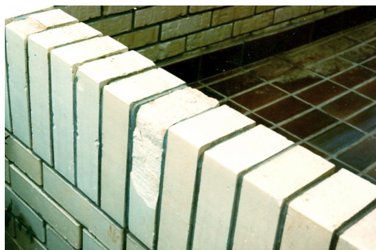
Sl. 2: Prikaz oštećenja fasadnog zida od opeka kao posledica dejstva mraza
