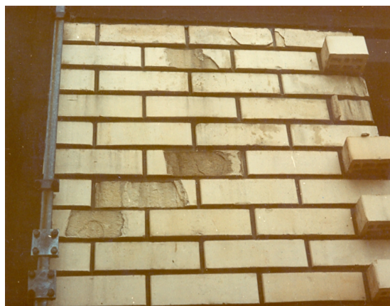
Sl. 1: Prikaz oštećenja fasadnog zida od opeka kao posledica dejstva mraza
