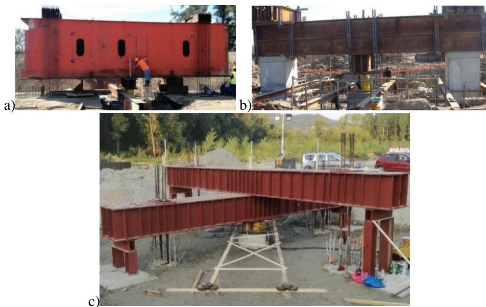
Slika 6. Test statičkog opterećenja šipa (SLT) - reaktivni sistem: a) most na koridoru XI (Surčin-Obrenovac) u Srbiji (reaktivni sistem formiran od zavarenog čeličnog nosača i četiri armiranobetonska šipa), b) silos pepela u TE Kostolac B u Srbiji (reaktivni sistem formiran od dodatno ojačanih udvojenih čeličnih nosača i dva armiranobetonska šipa), c) vijadukti za brze pruge u Čortanovcima u Srbiji (reaktivnim sistem formiran od udvojenih-ukrštenih čeličnih profila i četiri armiranobetonska šipa) [7]
